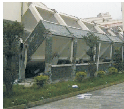
图3 教学楼A外廊侧框架柱损伤
