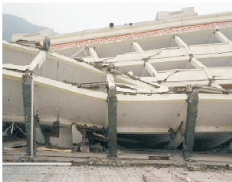
图2 教学楼A震后倒塌情况
