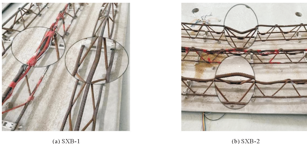
图7 桁架钢筋变形
