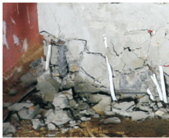
(c) 试验后期左侧钢筋变形
