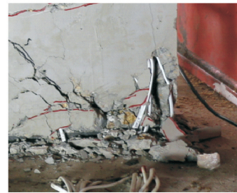
(d) 试验后期右侧钢筋变形
