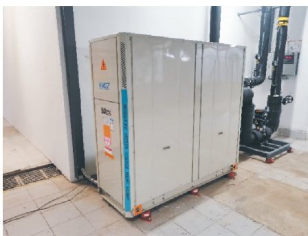
图2 水源热泵机组实物
