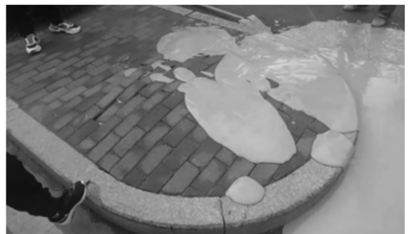
图1 八一公园顶进时“冒浆”现场照
