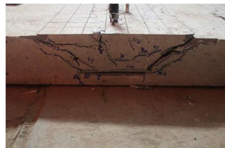
(d) 锚固板上方混凝土掀起
