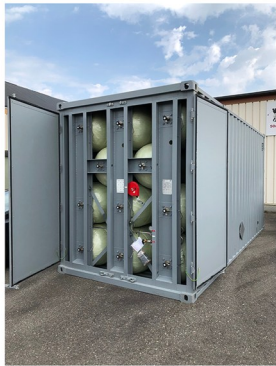
(c) 总容量达50 000 Nm 3 的储氢罐
