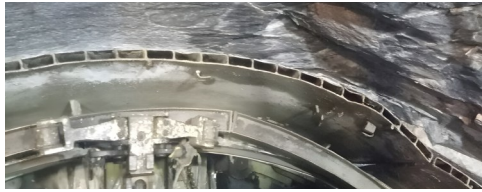
图 14 现场盾体变形
