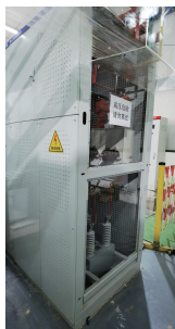
(d) 高压电容器柜
