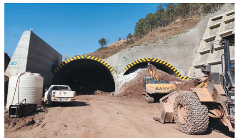
图 3 下寨隧道现场偏压情况
